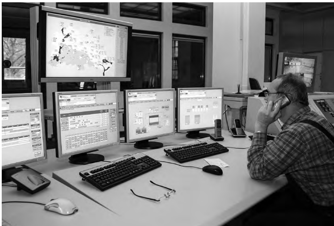
In der Schaltwarte des Wasserwerkes Beelitzhof wird die gesamte Trinkwasserversorgung Berlins gesteuert. Foto: Wecker
